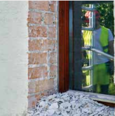
Trappen ned til ungdomslokalene må demonteres før muren kan utbedres
